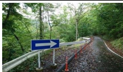
道路崩壊の現場
